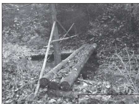
Stav lávky přes Libchyňský potok před rekonstrukcí.
