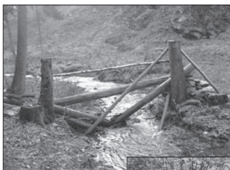
Stav lávky přes Janovský potok před rekonstrukcí.
